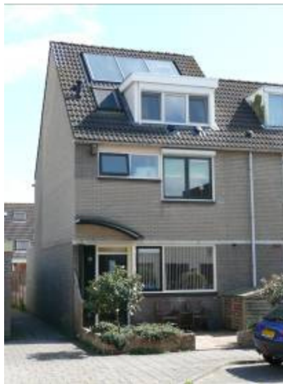
3 collectoren op schuin dak
