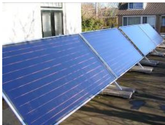
TopSon collectoren op plat dak
